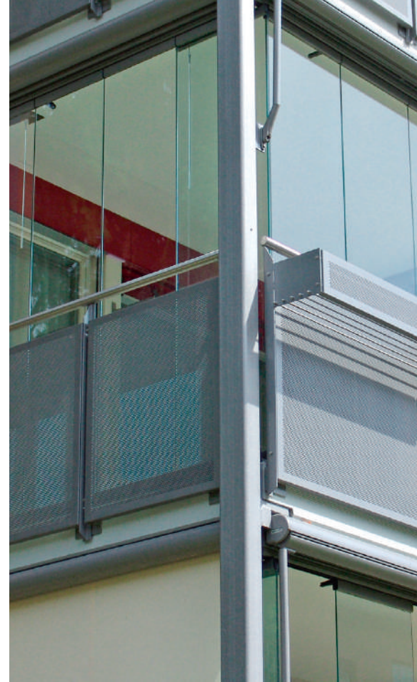
Drehbare Gläser benötigen Platz. Ein Blick an die Decke bei der ersten Objektbegehung hilft, Konflikte mit bestehenden Bauteilen zu vermeiden.
